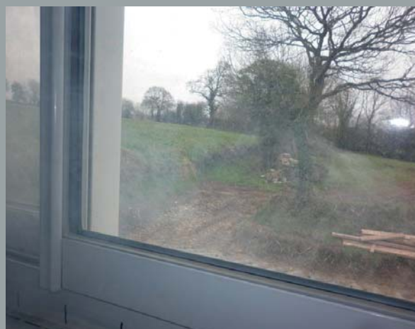
Fumée s'échappant d'une fenêtre coulissante lors du test d'étanchéité intermédiaire en surpression sur la rénovation C3 - 1 « LECRONIER »
